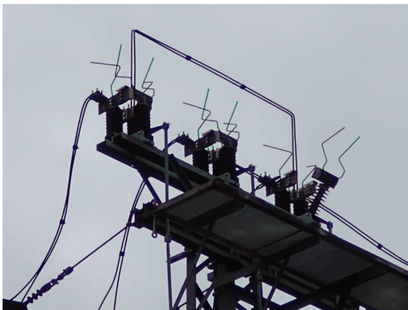
Obr. 8. Tři odpojovače na jednom stožáru. Pravý je rozepnut, levé dva jsou sepnuty.
