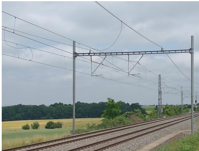
Obr. 11. Přídavné vedení je umístěné na izolátorech na vodorovném břevnu nad každou z obou kolejí. Vlevo a uprostřed snímku je patrné propojení přídavného vedení s trolejí. Přídavné vedení je vidět i na Obr. 4.
