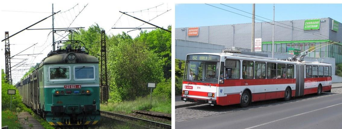
Obr. 1. Jednovodičové napájecí vedení nad železniční tratí a dvouvodičové trolejbusové vedení.
