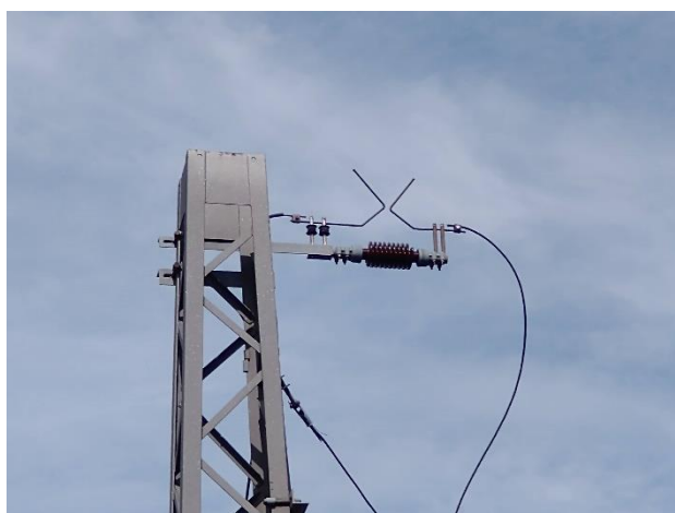
Obr. 3. Bleskojistka na stožáru nesoucím trolejové vedení. Levý růžek je uzemněn, vodič uchycený na pravý růžek vede k troleji. Oba růžky jsou odděleny izolátorem.
